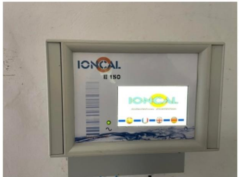
Imagen del descalcificador de nueva generación. - Foto: Ayto. de Pozo de Guadalajara
