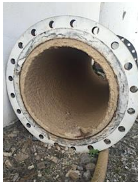
Comunidad de Regantes tuberías de 400mm
