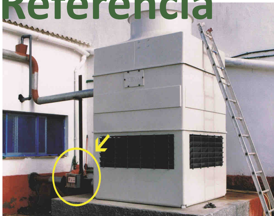
Planta El VENDRELL (Tarragona-España) Circuito cerrado de enfriamiento Aplicación: impulsiones agua refrigerada Torres
