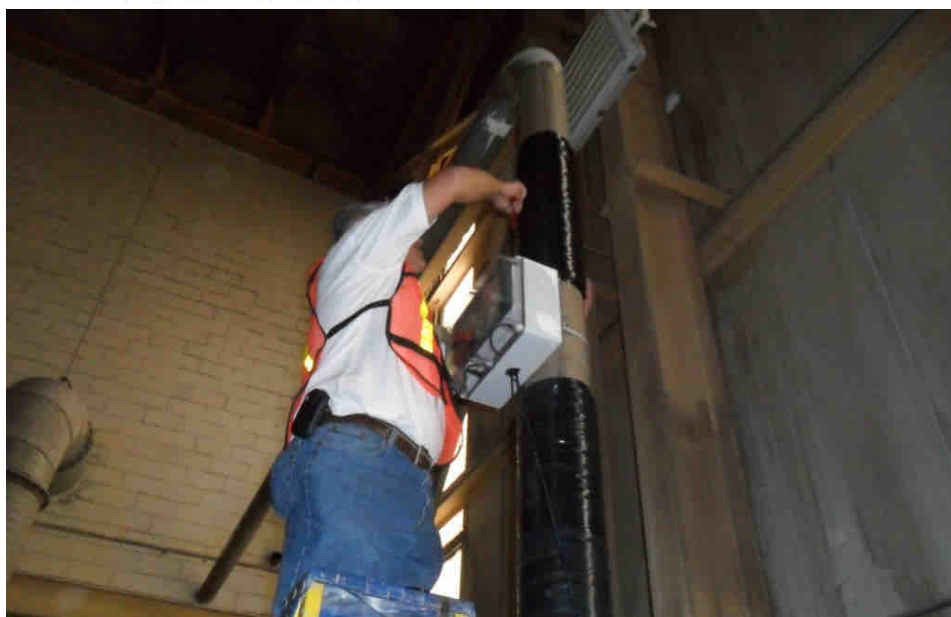
Planta RAMOS ARIZPE (Coahuila). Circuito semicerrado Aplicación: entrada intercambiador Percotherm
